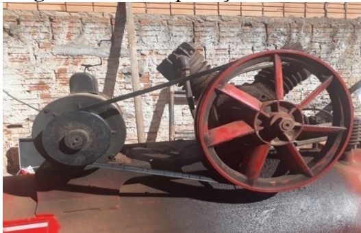
Figura1: Falta de proteção da correia.
