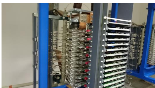
Figura 12: Válvulas de Tiristores
