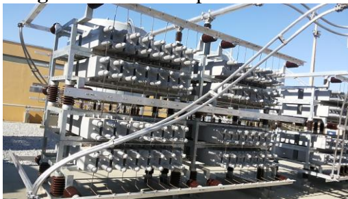
Figura 5: Banco Capacitores do CER
